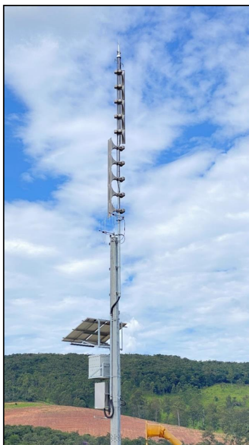
Figura 11.1 – Sirene implantada próximo a ZAS da mancha de inundação da Barragem B2
